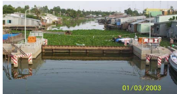
Hình 6. Đập Phước Long đang ngăn mặn
